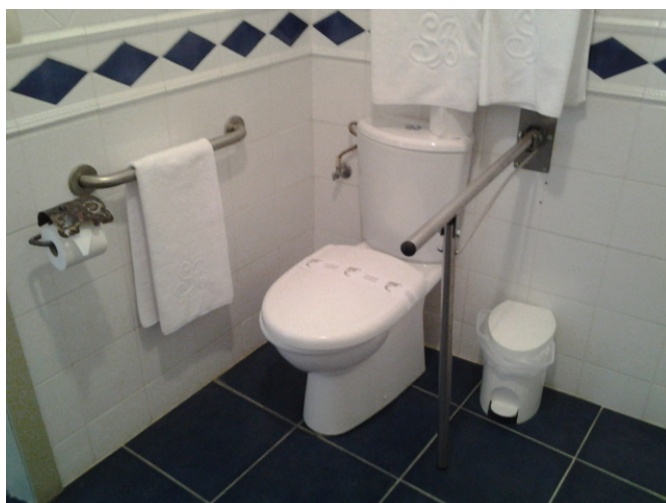
Aseo habitación adaptada
