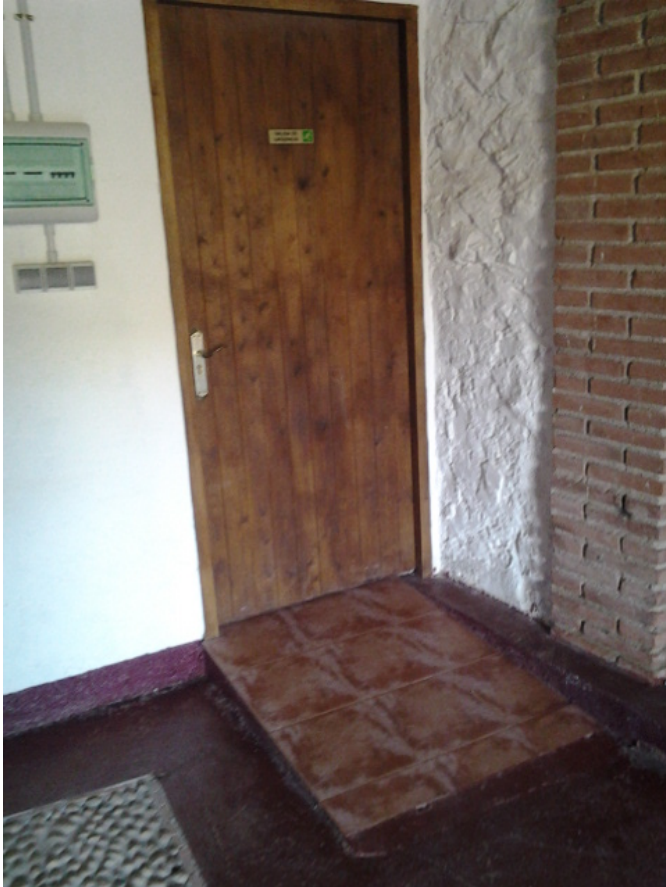
Rampa de acceso al aseo adaptado
