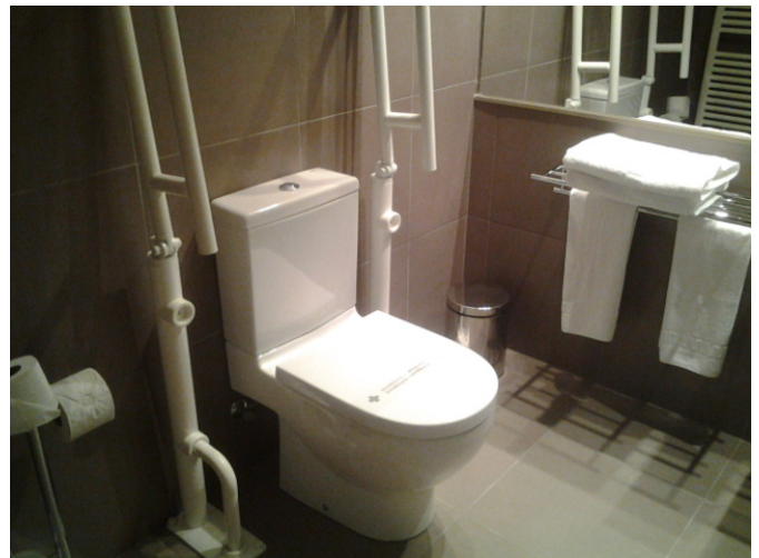
Aseo habitación adaptada
